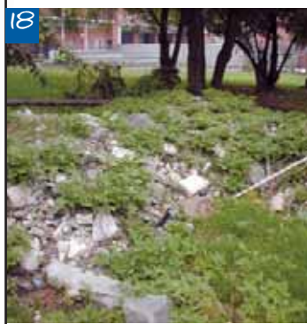
18 Abbandono di macerie con frammenti di lastre in cemento-amianto
