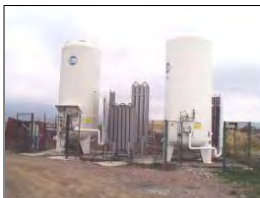
Serbatoi di ossigeno liquido
